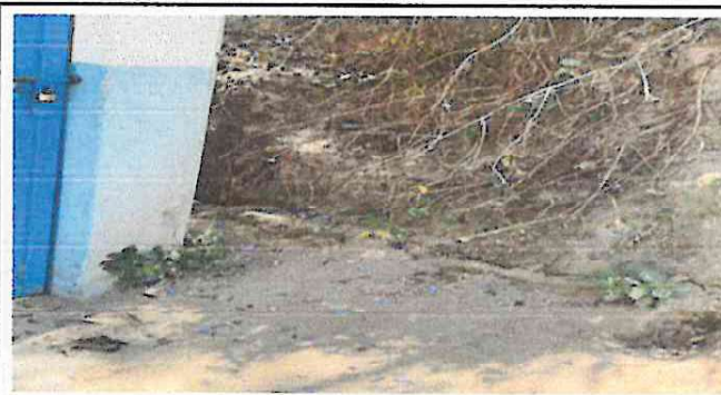
Foto 8: En esta parte se vino un deslave de lodo el cual dejo soterrado parte del muro perimetral
