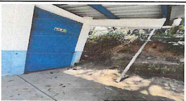
Foto 9: aca podemos observar como quedo despues de limpiar la zona afectada por el deslave
