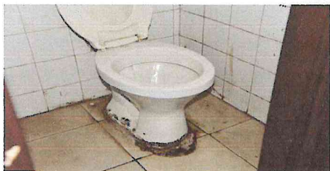
Foto 3: los sanitarios están tapados las tuberías, otros están rotos y en malas condiciones.
