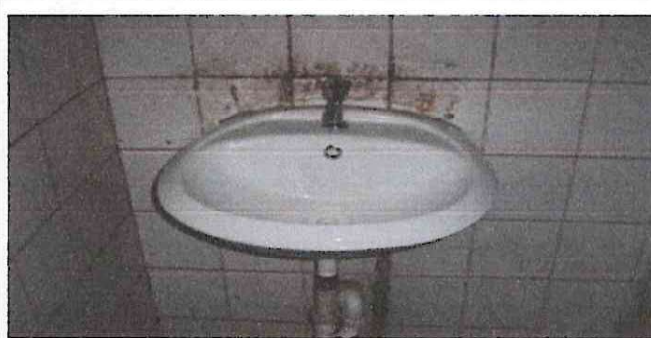
Foto 2: los lavamanos están fuera de servicio por deterioro de tubería y llave del mismo ya que tienen muchas fugas.
