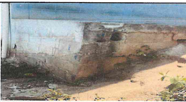
Foto 10: esta parte de abajo del corredor tambien fue afectada por el deslave llevandose tambien parte del muro de contencion que ahí habia
